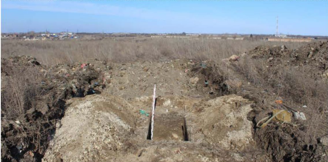
Рис. 61. Объект: «Рекультивация свалки, расположенной по адресу: Ростовская область, Неклиновский район, с. Покровское ( в южной части села), ул. О. Кошевого, полигон твердых бытовых отходов». Шурф 6. Вид до рекультивации. Вид с З.
