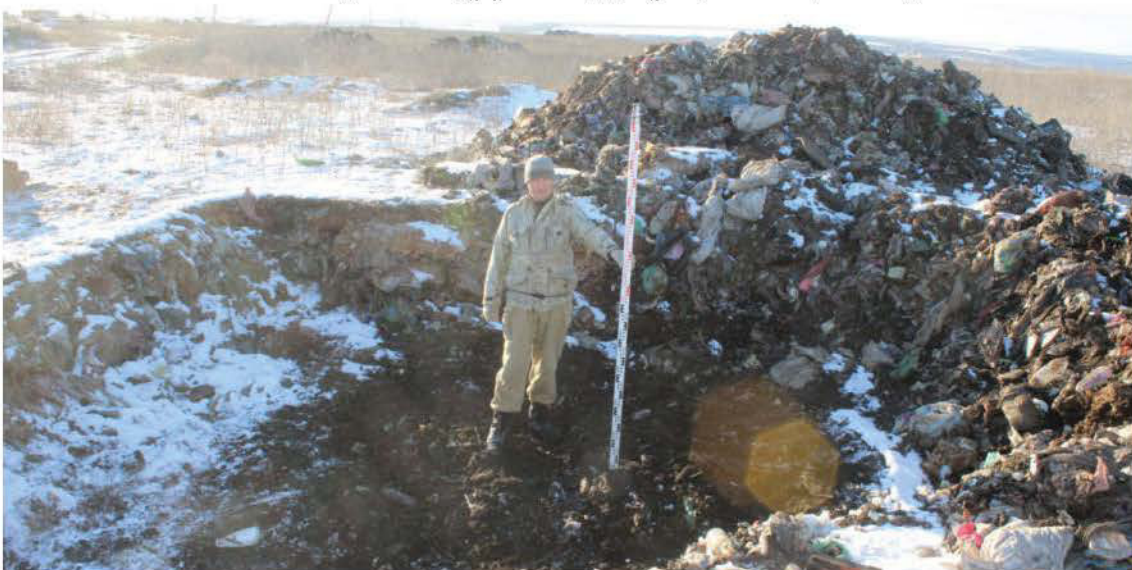
Рис. 47. Объект: «Рекультивация свалки, расположенной по адресу: Ростовская область, Неклиновский район, с. Покровское ( в южной части села), ул. О. Кошевого, полигон твердых бытовых отходов». Шурф 3. Вид после окончания работ с 3.
